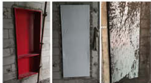
未防护的成品消防箱 使用PE薄膜的消防箱，内部依然完好无损
