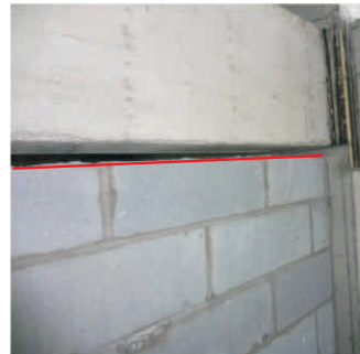
内墙顶与梁底留置50缝隙，符合要求。
